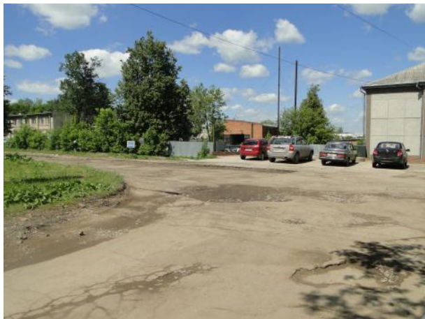
Состояние дороги до ремонта
