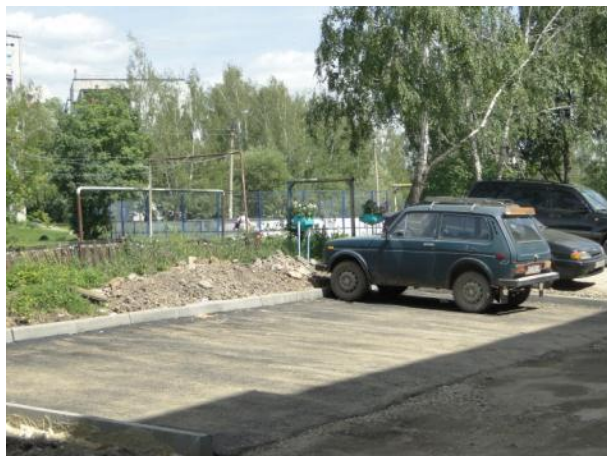
д. 9 Оборудование парковки
