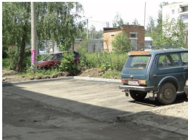
д. 9 Оборудование парковки
