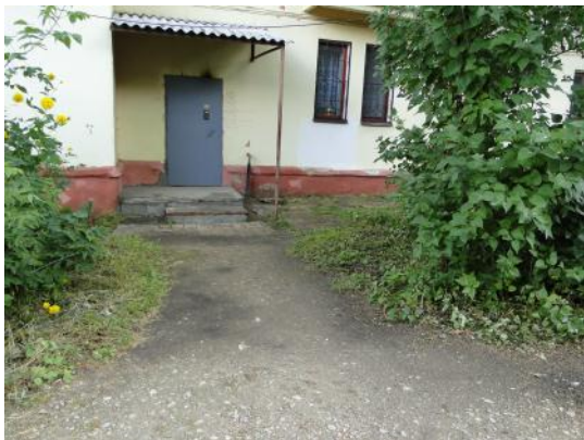
д. 19 До ремонта
