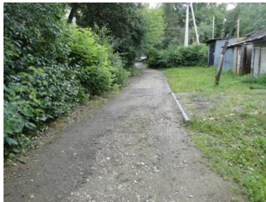
д. 19 До ремонта
