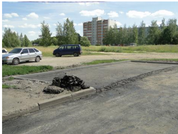
д.14 Оборудование парковки
