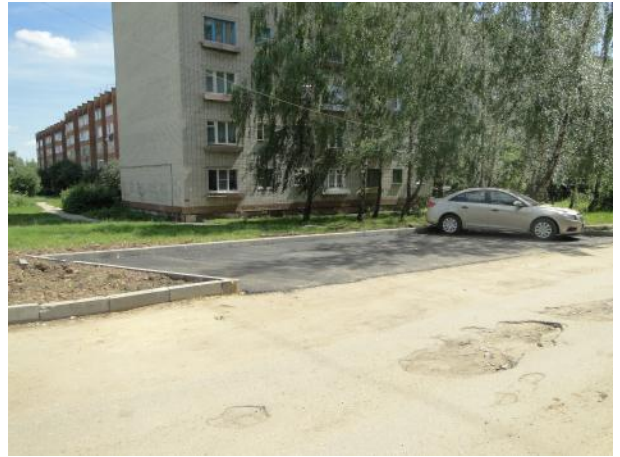
д.4 Оборудование парковки
