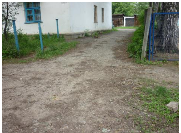
д.9 До ремонта
