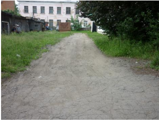
д.8 До ремонта
