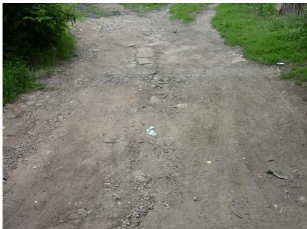
д.13 До ремонта
