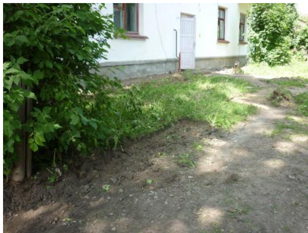
д.10 До ремонта
