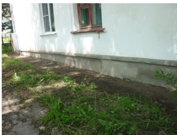
д.10 До ремонта
